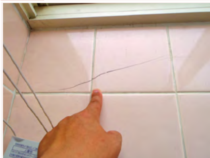
▲壁タイルの割れ
