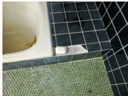
▲エプロン部のタイル欠損
