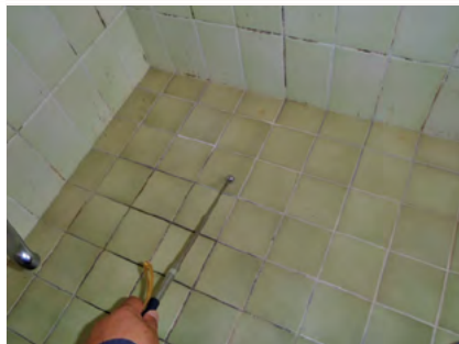
▲床タイルの浮き
