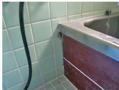
▲壁タイルの欠損
