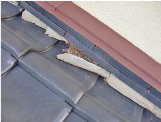
▲面戸モルタルの割れ
