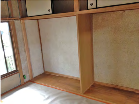
▲既存じゅうく塗り部分の剥離
