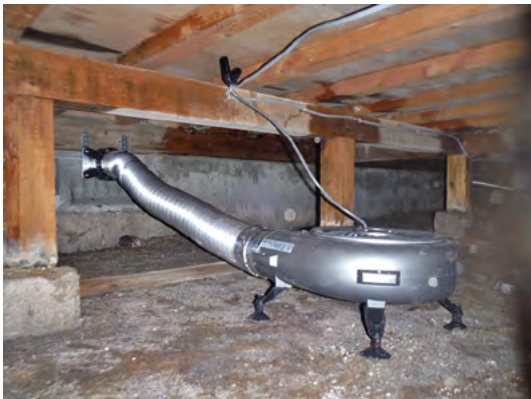
▲機械換気設備設置事例
